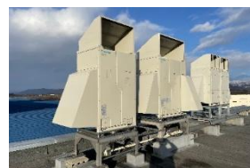
生産フロア（室外機）
