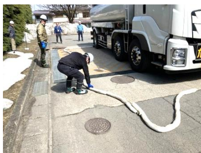
<重油地下タンク（重油漏洩）>
