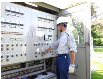
<合併処理浄化槽（放流水異常）>
